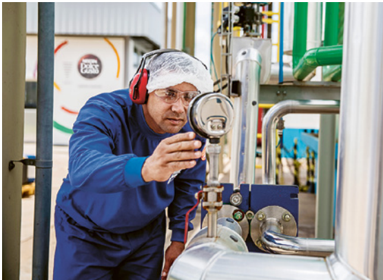
Notre usine Nescafé Dolce Gusto de Montes Claros, au Brésil, a atteint le stade du triple zéro: zéro eau pour élimination définitive, zéro déchet pour élimination définitive et zéro émission nette de GES.
